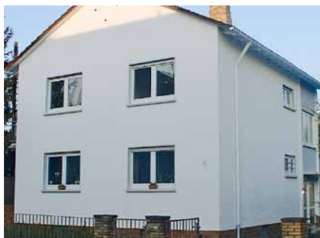
Unmodernisiertes Zweifamilienhaus aus den 1960er-Jahren mit starken Wärmebrücken an den Außenwänden in den Bereichen der Deckenanschlüsse,...
