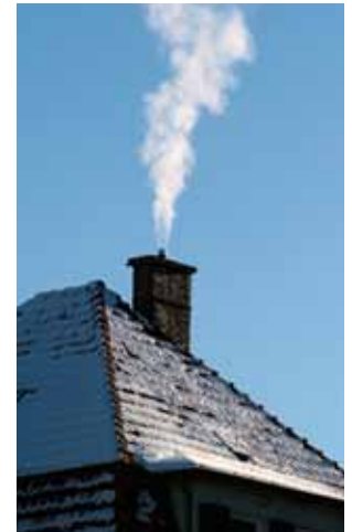
Aus dem Schornstein entweichender Wasserdampf ist ein Zeichen für eine unvollständige Kondensation der Abgase im Brennwertkessel.
