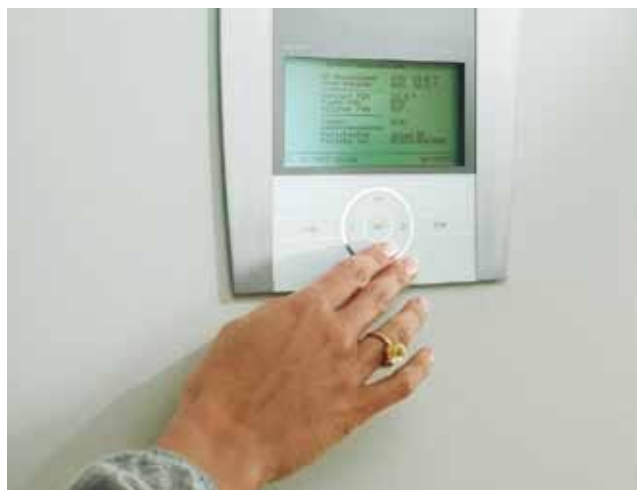
Eine ausgeklügelte Steuerung der Raumheizung erleichtert den achtsamen Umgang mit Heizenergie.
