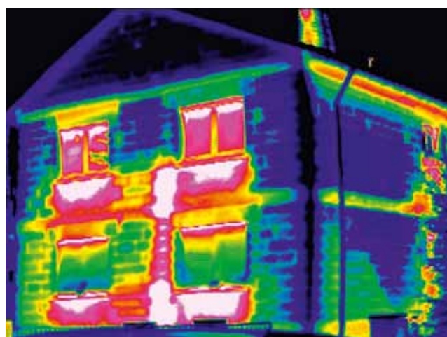
...Rollladenkästen, Heizkörpernischen und Heizungsleitungen. Die Wärmebildkamera macht diese Wärmebrücken hier eindrucksvoll sichtbar.
