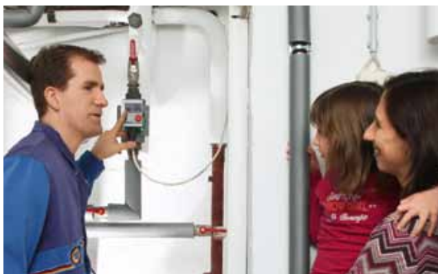
Der Austausch einer alten, unregelmäßig arbeitenden Heizungspumpe gegen eine moderne Hocheffizienzpumpe spart jährlich mehrere Hundert Kilowattstunden Strom.
