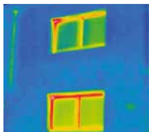
Die grünen und blauen Flächen zeigen „kalte“ Fenster und Wände – ein deutlicher Unterschied.
